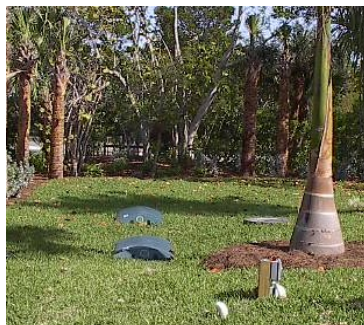
900 Gallon Per Day System
